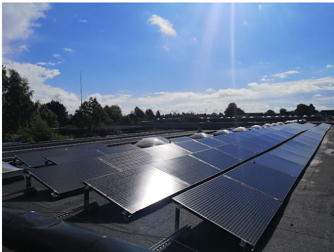
Figur 1: Solet anlæg opstillet på tag.
